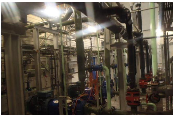
Podávací čerpadla WEIR
