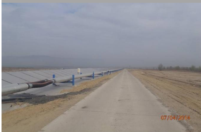
Plavící potrubí na úložišti
