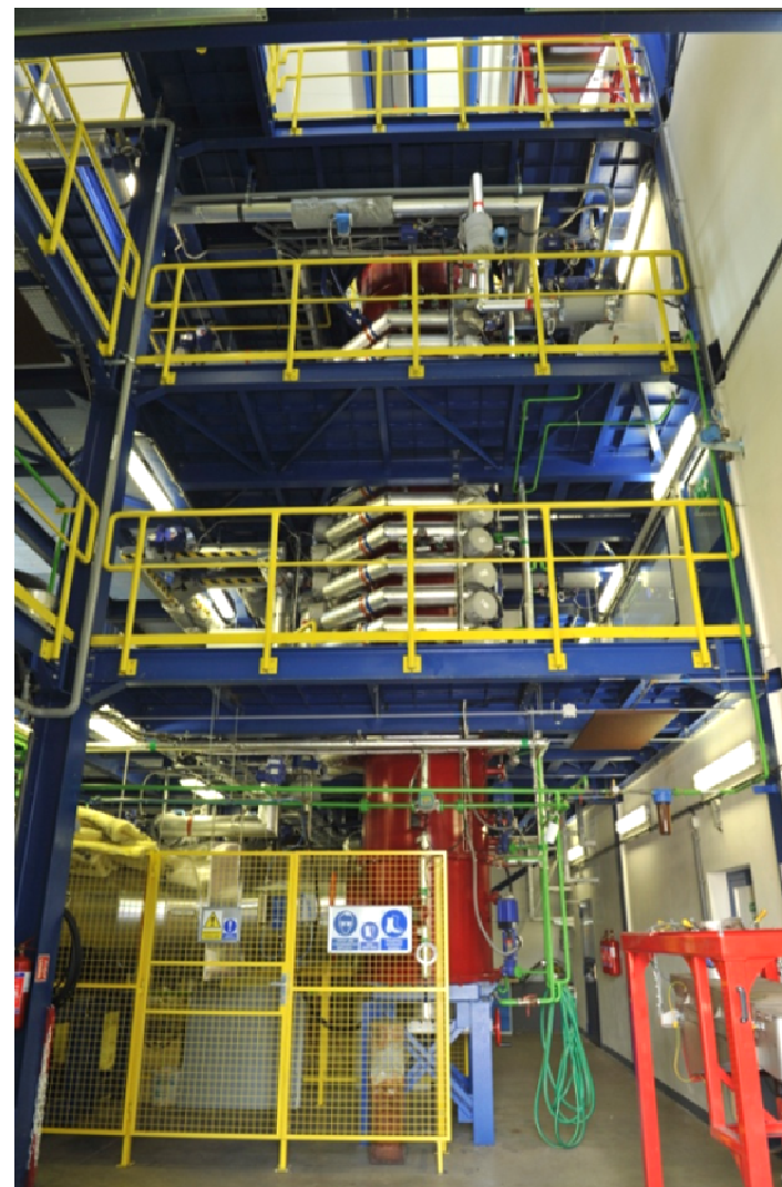
Zkušební spalovací zařízení
